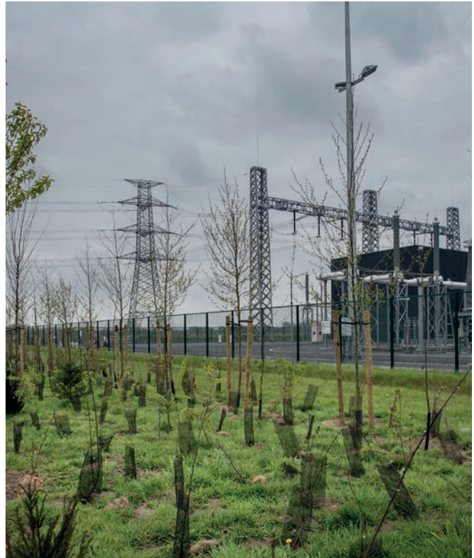
Voorbeeld van aanplanting groenscherm bij een nieuw hoogspanningsstation
